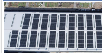
滁州合一1.3MW工商业光伏项目
